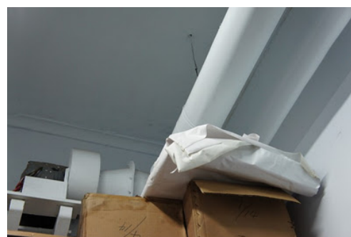
圖 26. 通風管線經由第二暗室將廢氣排到室外。
