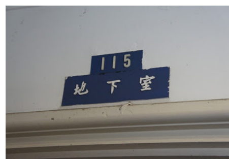
圖 28. 早年的地下室指示牌。
